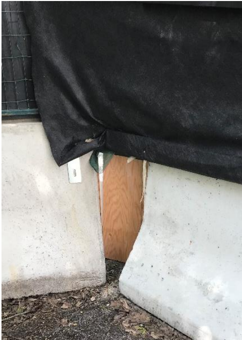
Jointures bouchées entre les glissières
