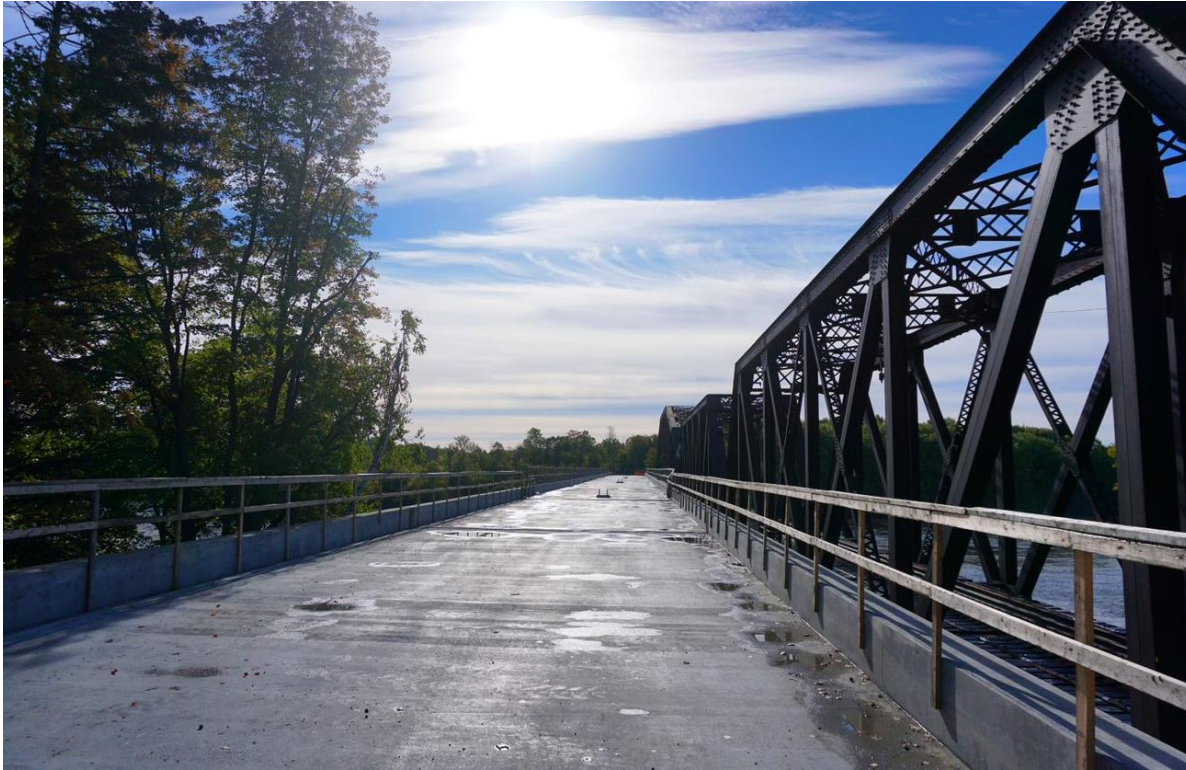
Vue « sur » RDP1
